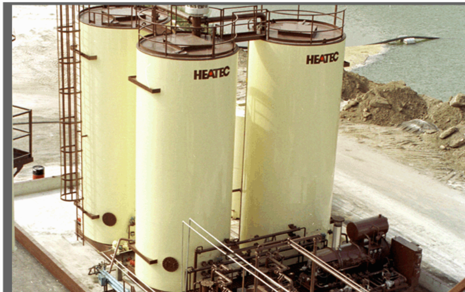
Entreposage du bitume avec reservoirs verticaux
