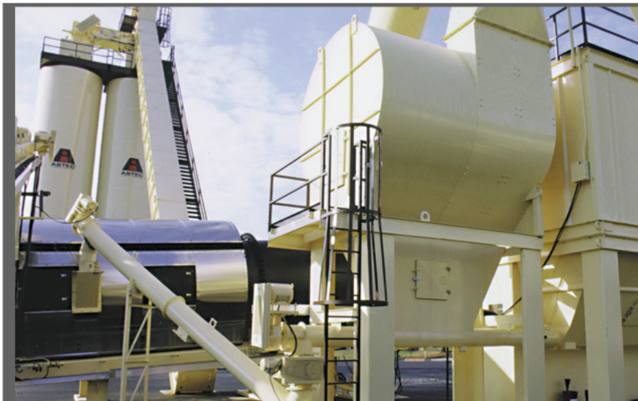
Dépoussiéreur avec cyclone horizontal
