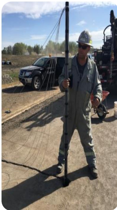
INSTALLATION DES CAPTEURS
