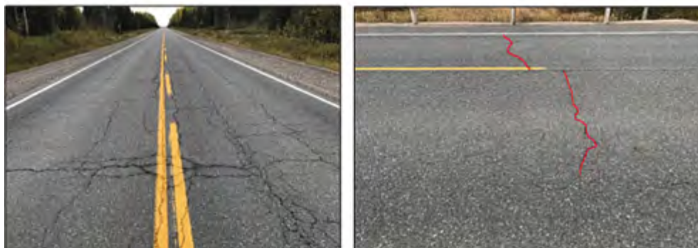
Figure 9 : Observation des fissures sur le terrain lors de la visite des sections 4 (à gauche) et 1 (à droite), sur la route 655, Ontario, Canada
